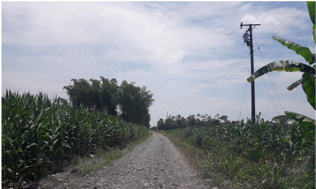
Imagen 24 Red de energía eléctrica en Lago San Pedro
